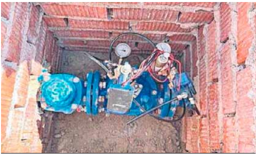
Uno de los equipos instalados.
